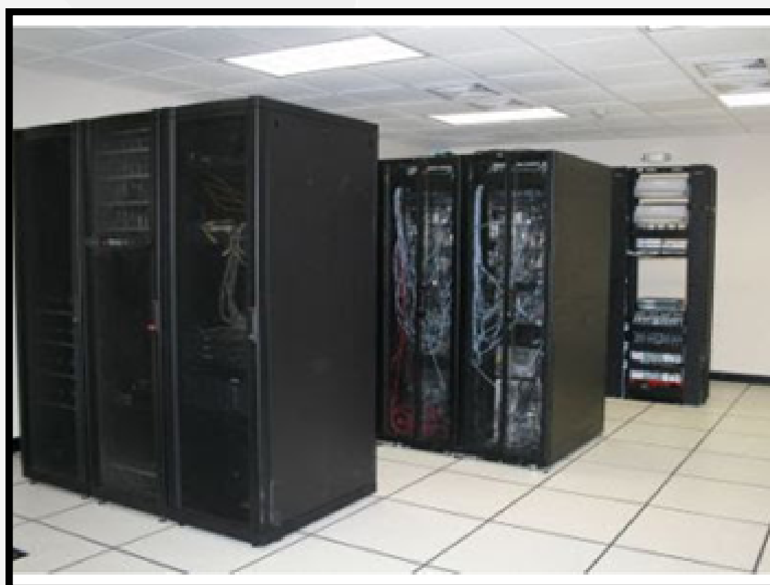
Bilik Pelayan ( Server )
